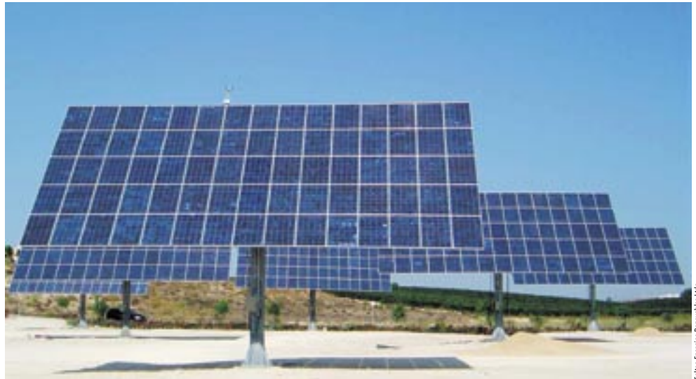
Der Sonne folgen: Wie dieser Solarpark mit knapp 900 Kilowatt Leistung, den die Soltec Energías Renovables SL am Firmstandort in Molina de Segura errichtete, bestehen weit über die Hälfte aller spanischen Großanlagen aus Nachführsystemen.
